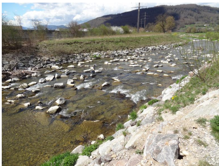
Abb. 6: Beispiel für Massnahmen zur Längsvernetzung – aufgelöste Rampe an der Wigger in Aarburg AG
